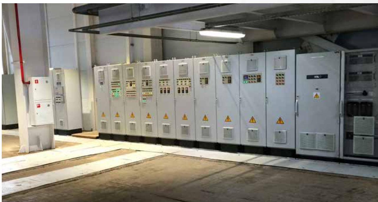
САУ и НКУ газотурбинной установки
